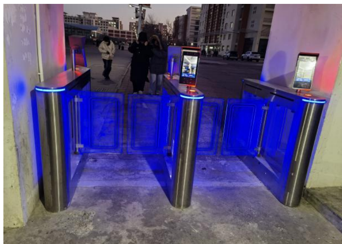
图 6-14 学院重要出口的道闸管控系统
