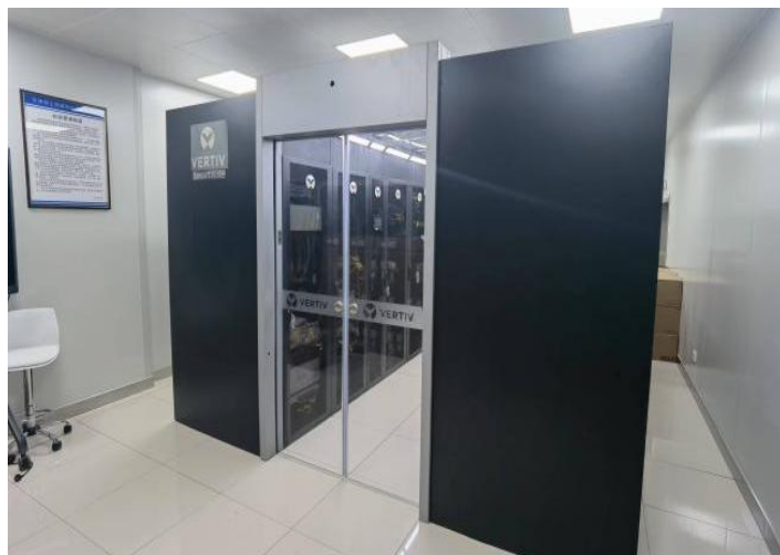
图 6-11 模块化机房正式落成外观图
